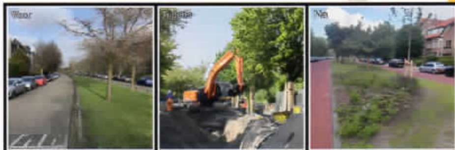
Drie keer de Boerhaavelaan in beeld: voor, tijdens en na de werkzaamheden. Ook in het Houtkwartier-Oost werkte De Vries Stolwijk aan de duurzame wijkvernieuwing.
